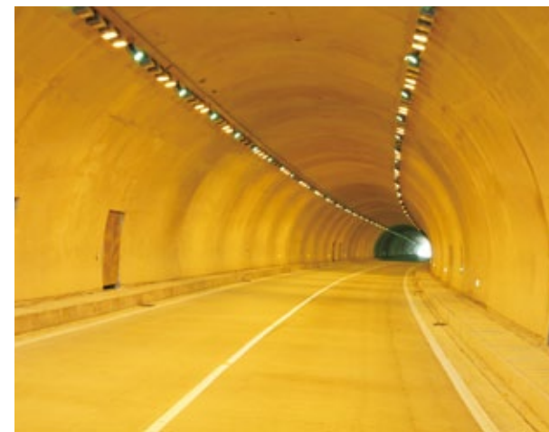
隧道灯示范工程
